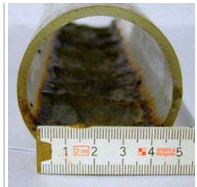
Fig. 4 Dépôt après 9 mois dans un conduit de diamètre DN 50 mm.
